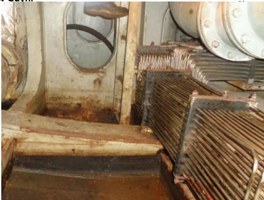
Rys. 8 Przewody zasilania hydraulicznego do zaworów balastowych w tunelu statku
