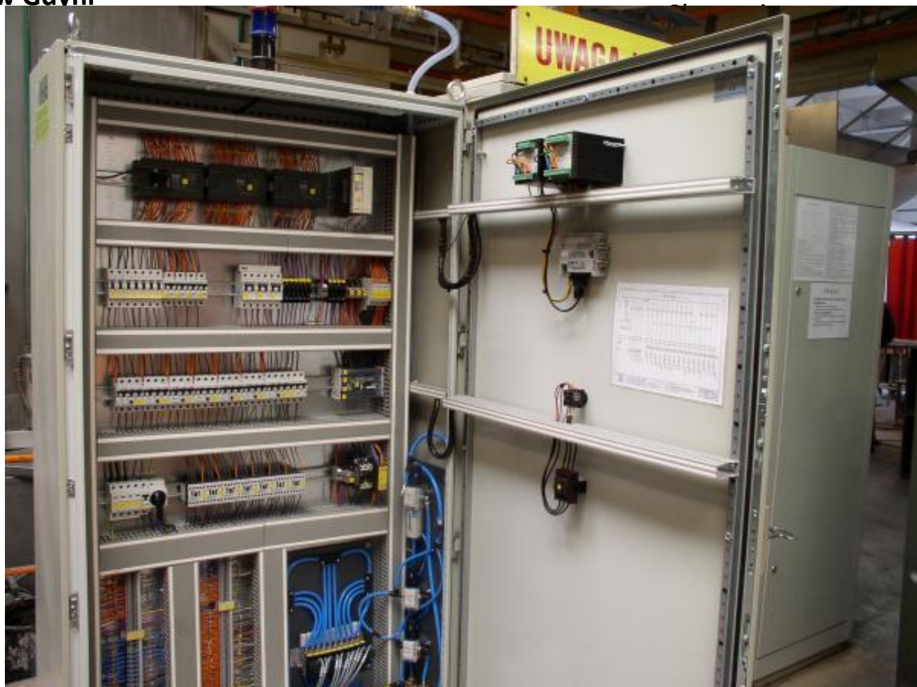
Rys. 9 Szafka sterująca do zaworów w tunelu statku
