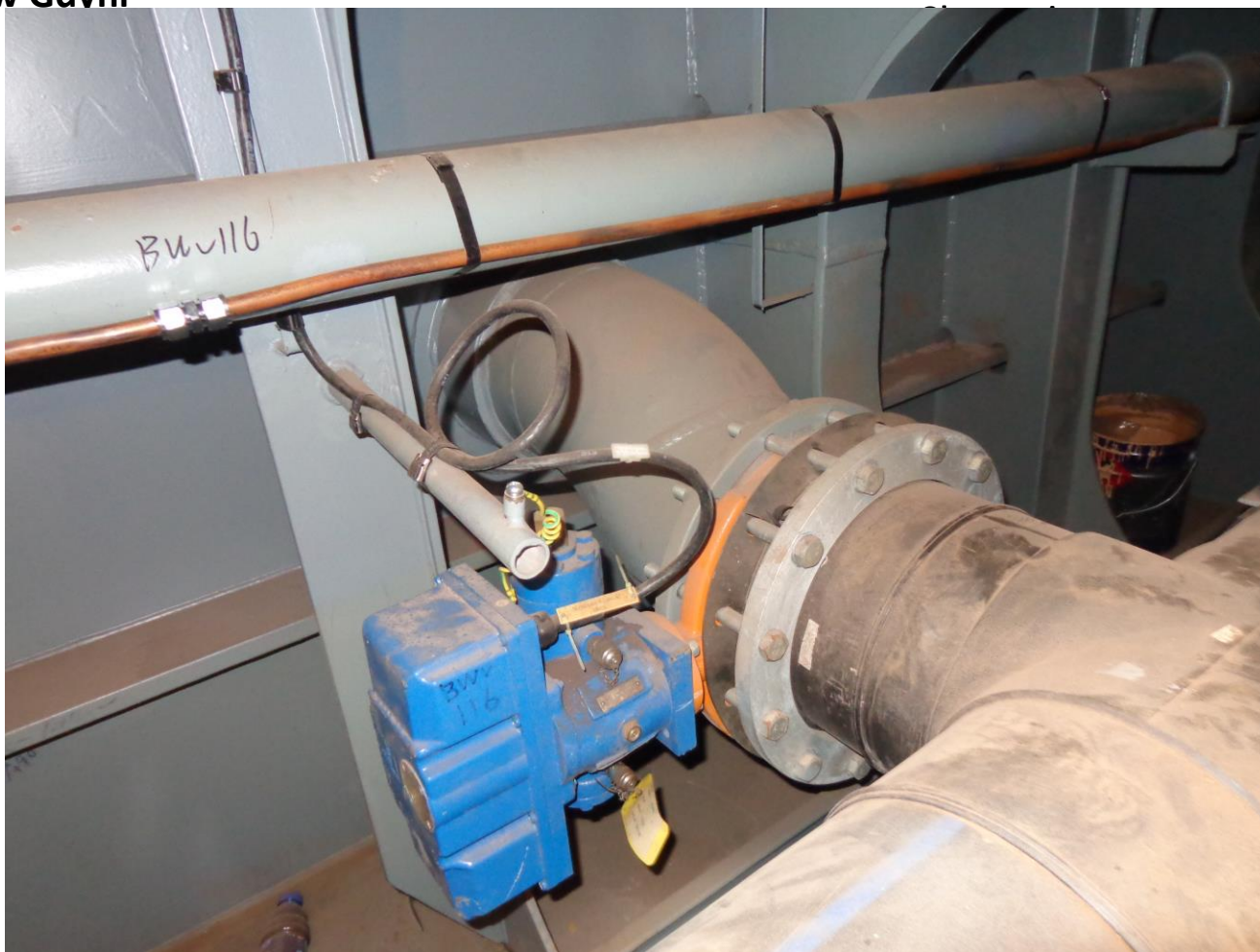
Rys. 11 Zespół zaworu motylkowego z siłownikiem elektro-hydraulicznym
