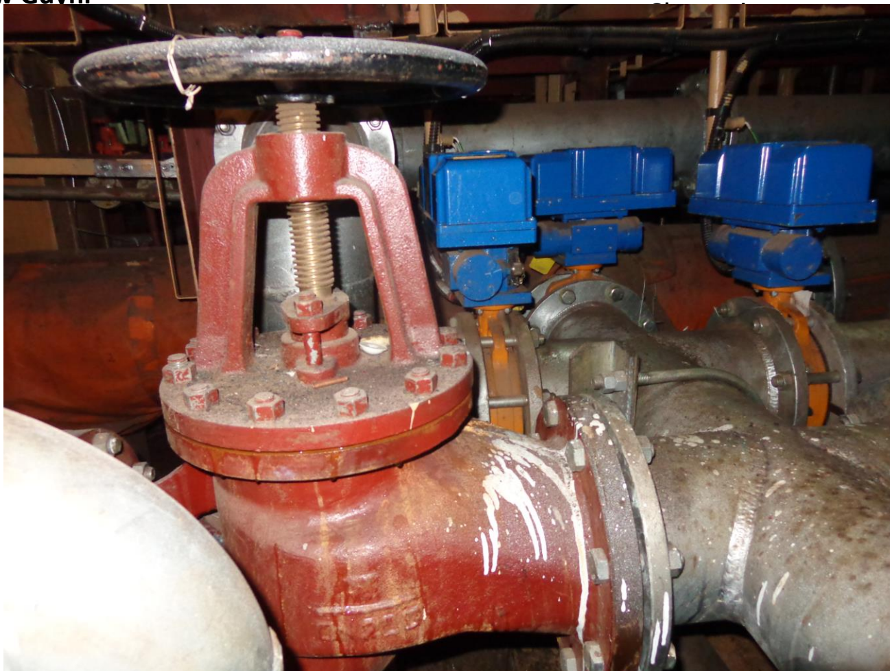
Rys. 10 Zawory elektro-hydrauliczne w tunelu statku
